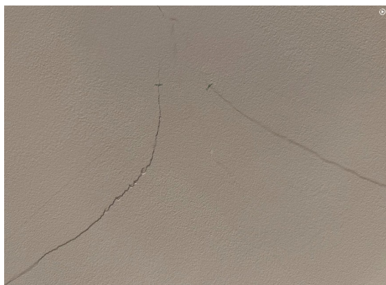
Figure 6 : Présence d'un marquage au niveau des fissures pour marquer leur terminaison.
