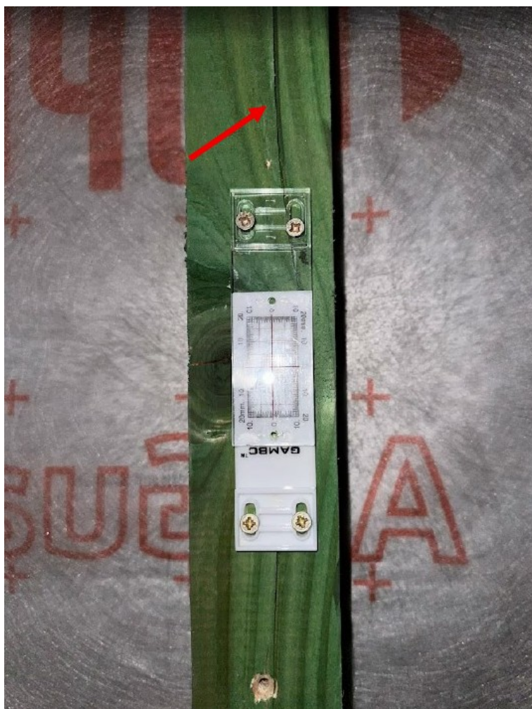
Figure 10 : Photo de la fissure sur la panne centrale
