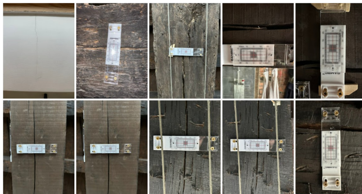
Figure 6 : Différents fissuromètres en place
