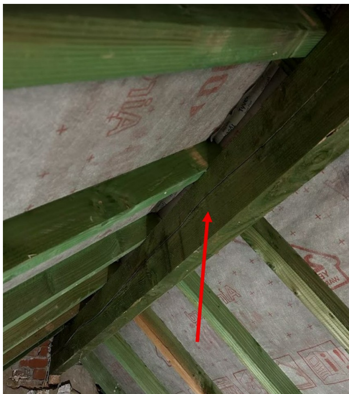
Figure 7 : Fissure dans la panne faîtière
