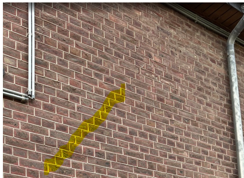
Figure 7 : Légère dissociation des briques de façades
